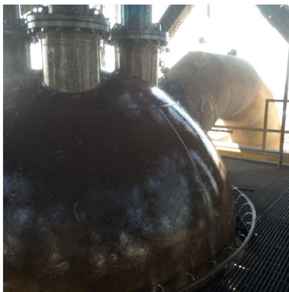
Vannkjøling av reactor
