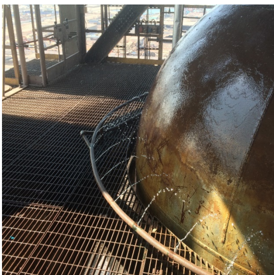
Vannkjøling av reactor
