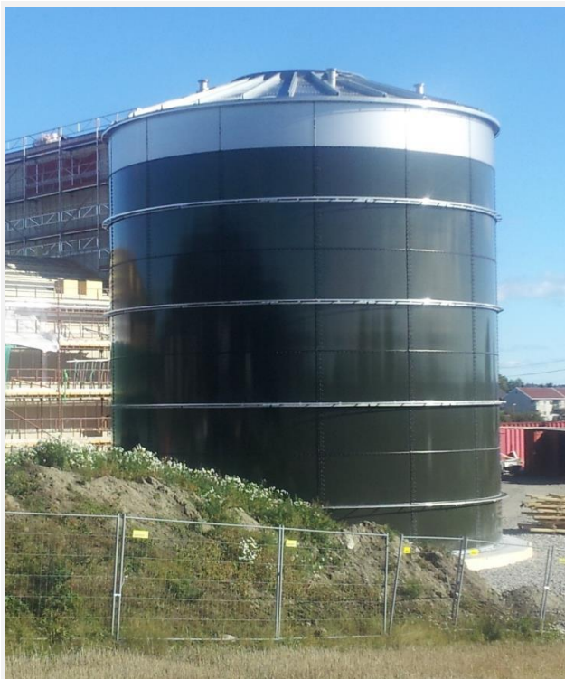
Råtnetank i stål med emaljert innside før isolering og kledning.
